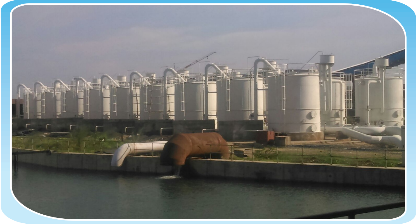
18 台设备，每台容量为 160 立方米/小时，安装在 BHEL, Uttar Pradesh
