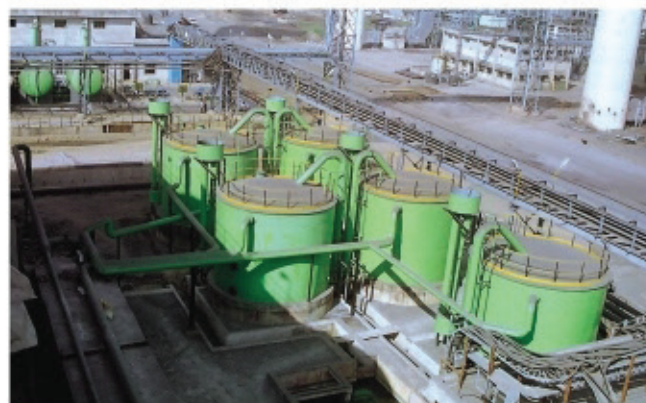
Parte do sistema de tratamento de água fornecido à Bhusan Steel & Strips Limited
