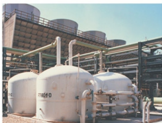
Tratamento de água de arrefecimento
