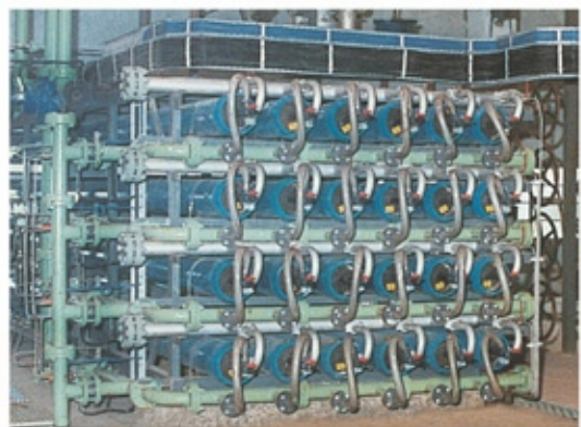
Instalação de dessalinização por osmose inversa da água do mar
