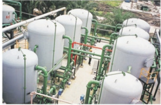
Instalação de desmineralização
