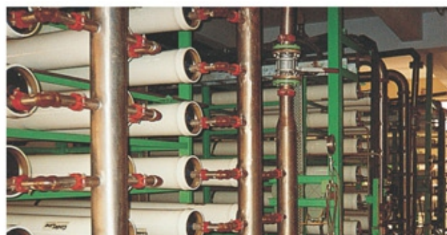
Instalação de descarga zero
