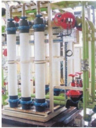
Instalação de ultrafiltração
