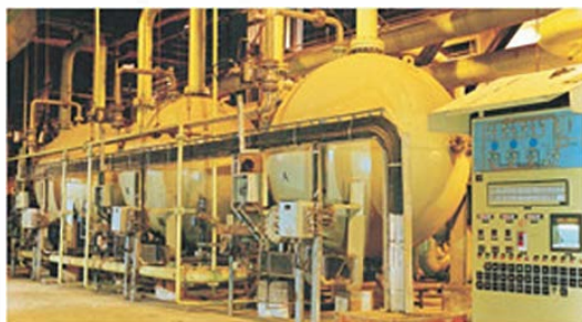
Unidades de pulido de condensados
