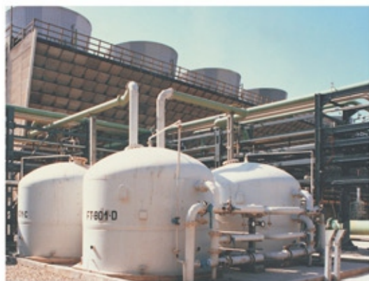
Tratamiento del agua de refrigeración
