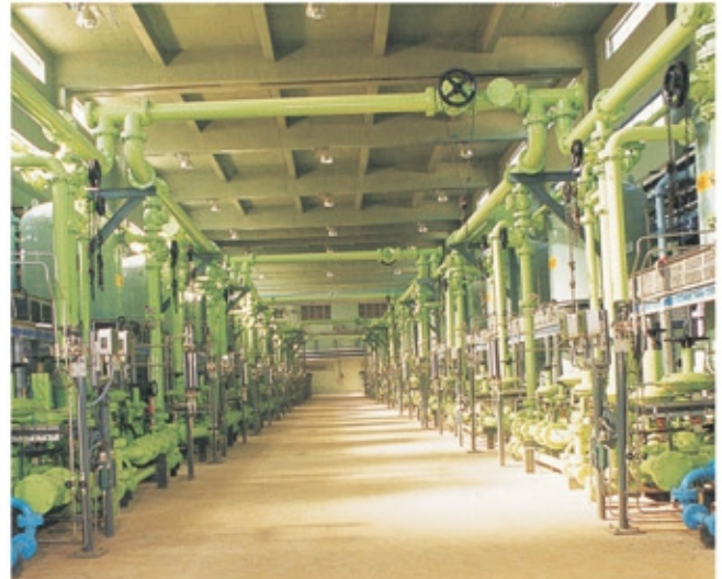
Servicios de operación y mantenimiento en estaciones eléctricas
