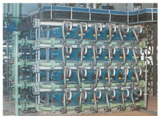
Planta desalinizadora por ósmosis inversa de agua de mar
