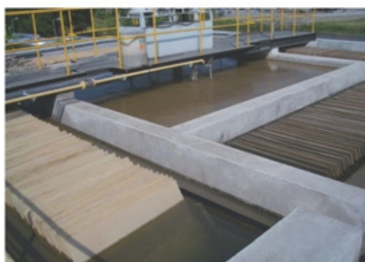
Clarificador de tasa ultra alta
