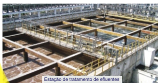
Estação de tratamento de efluentes
