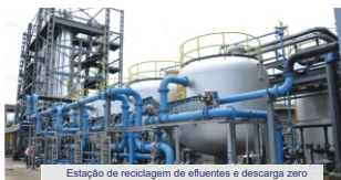
Estação de reciclagem de efluentes e descarga zero
