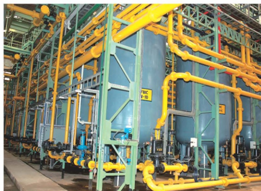
Instalação de recuperação de urânio na indústria mineira
