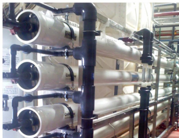
Instalação de osmose inversa na indústria de alimentos e bebidas
