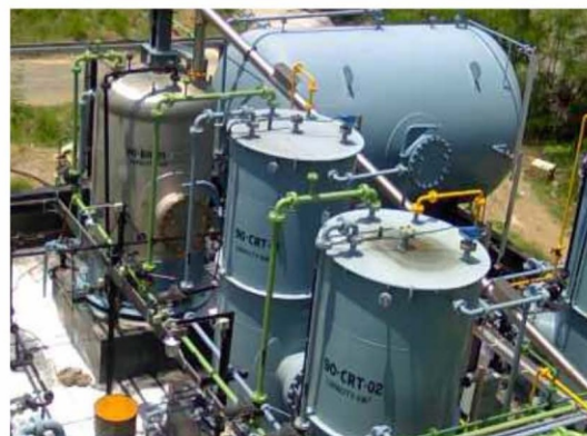
Instalação de enriquecimento de boro para a Heavy Water Board
