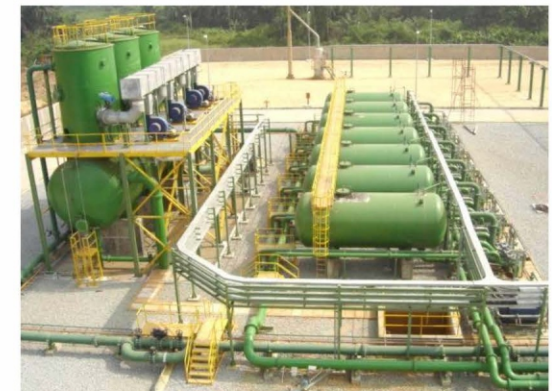
Sistema de filtragem em central elétrica
