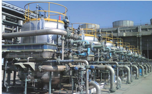
Instalação de desmineralização na indústria petrolífera
