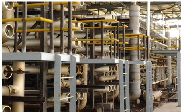
Osrose inversa de água do mar (dessalinização) na central térmica
