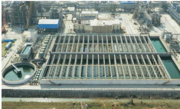
Planta de tratamiento de efluentes para la industria siderúrgica
