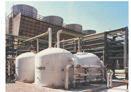
Tratamiento del agua de refrigeración
