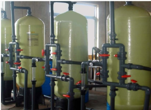
Planta de eliminación de arsénico para el tratamiento de aguas subterráneas
