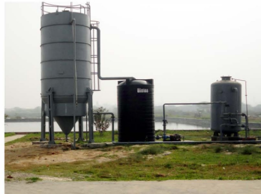
Filtro continuo de arena para tratamiento de aguas superficiales
