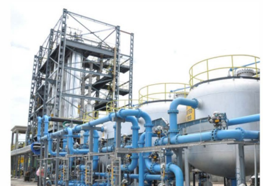
Sistema de vertido de líquido cero en una planta de caucho sintético
