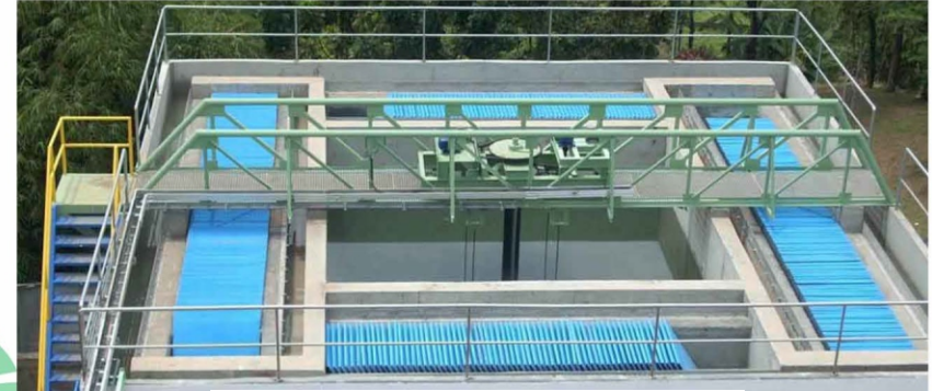
Clarificador de tasa ultra alta para planta textil
