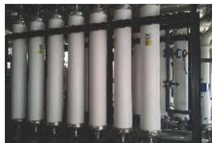
Instalação de ultrafiltração
