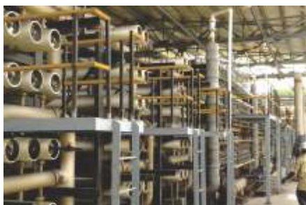
Instalação de osmose inversa
