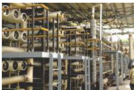
Planta de ósmosis inversa
