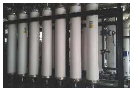
Planta de ultrafiltración
