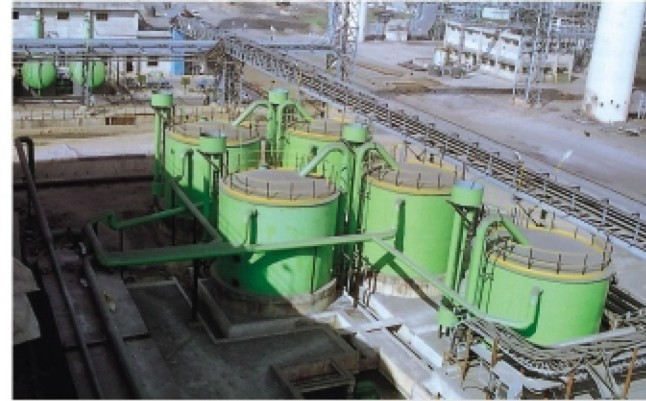
Parte del sistema di trattamento dell'acqua fornito a Bhushan Steel e Strips Limited
