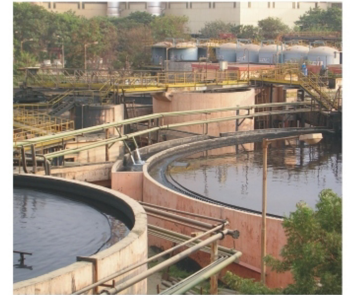
Gestione del circuito idraulico completo presso JSW Steel
