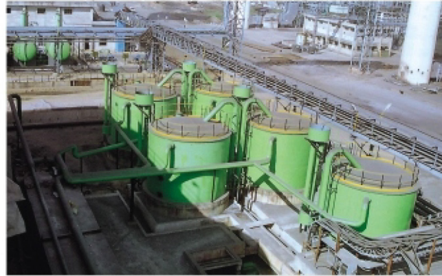
Partie du système de traitement de l'eau fourni à Bhushan Steel et Strips Limited
