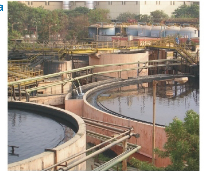
Gestion complète du circuit d'eau chez JSW Steel
