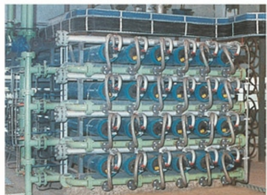
Impianto di desalinizzazione dell'acqua di mare ad osmosi inversa
