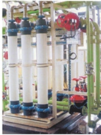
Impianto di ultrafiltrazione
