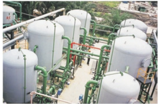
Impianti di demineralizzazione
