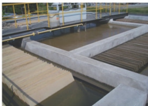
Clarificateur à très haut débit
