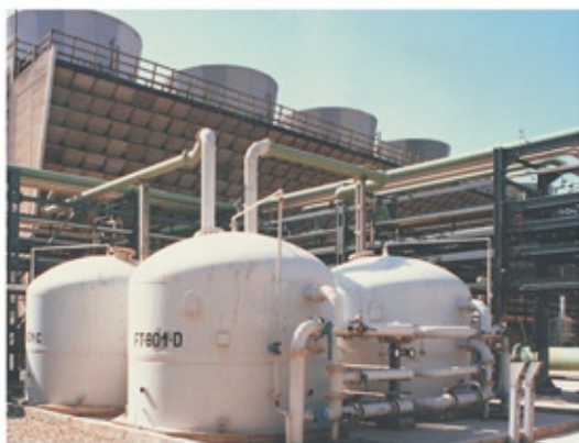
Traitement des eaux de refroidissement
