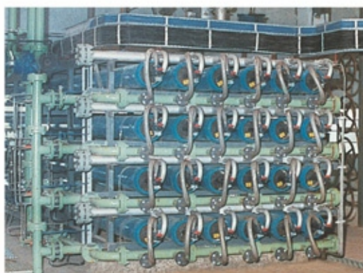
Установка опреснения морской воды обратным осмосом
