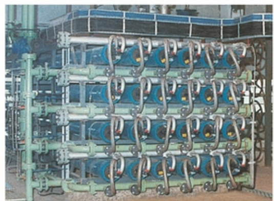
해수 역삼투 탈염 공장
