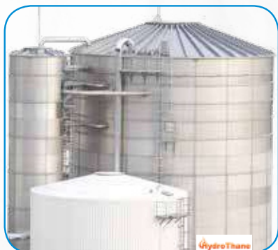
INDION Высокопроизводительная анаэробная очистка
