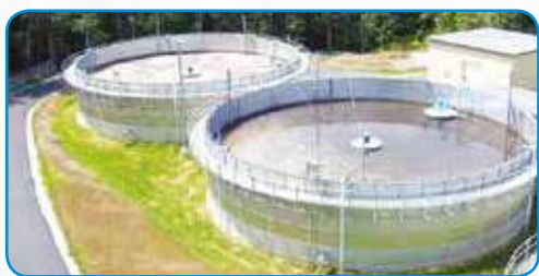
INDION Reattore batch di sequenziamento (SBR)
