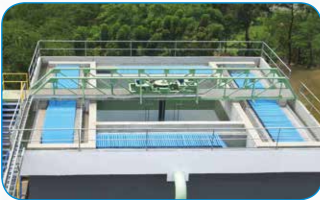
Clarificateur à contact avec les solides à très haut débit (UHRSCC)
