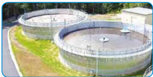
INDION Réacteur discontinu de séquençage (SBR)
