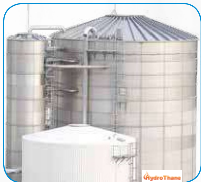
INDION 高速嫌気性処理
