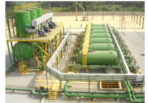
نظام الترشيح في محطة توليد الكهرباء
