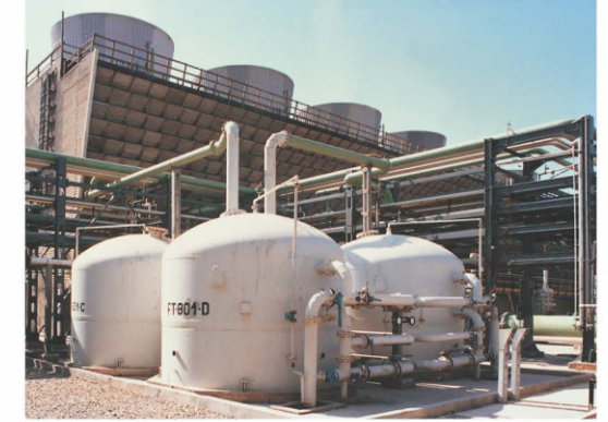
معالجة مياه التبريد
