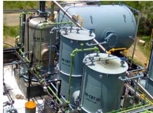
محطة تخصيب البورون للوحة المياه
