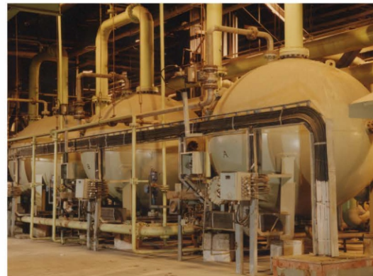
وحدات تلميع المكثفات لمحطة توليد الطاقة
