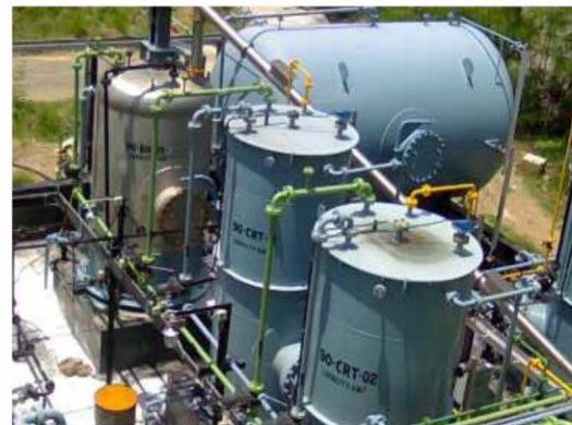
Boranreicherungsanlage für die Schwerwasserbehörde
