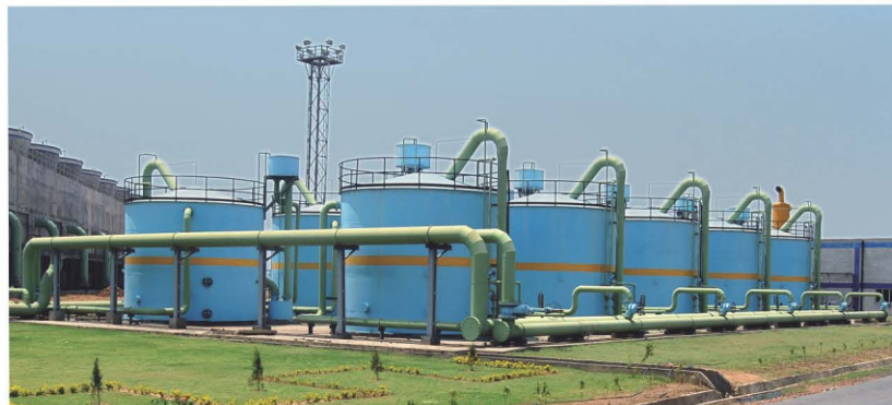
Seitenstromfilter im Stahlwerk
