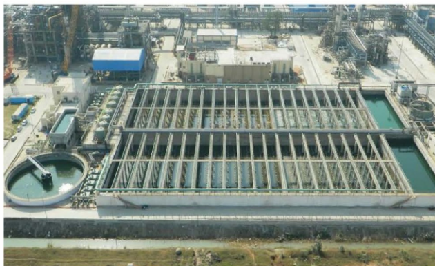
Kläranlage für die Stahlindustrie
