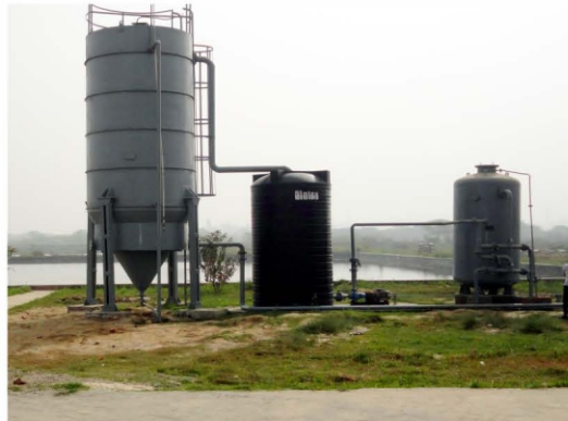
Kontinuierlicher Sandfilter für die Oberflächenwasseraufbereitung
