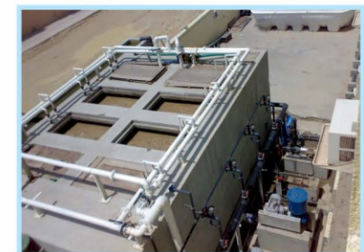
Membranbioreaktor in einem kommerziellen Gebäudekomplex
