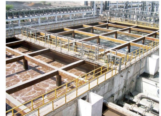
Abwasserbehandlungsanlage in einer Raffinerie
