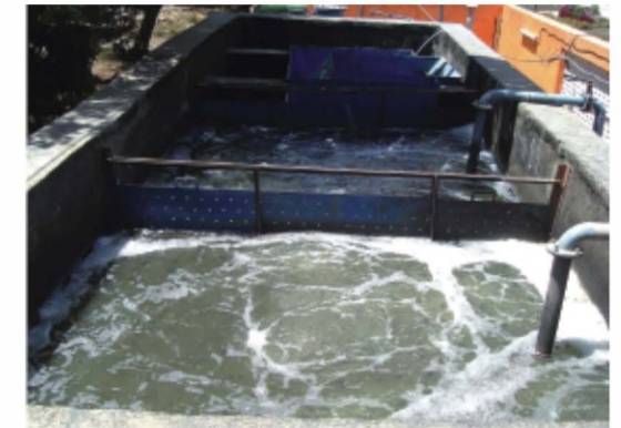
Réacteur à milieu fluidisé dans un hôtel traitement des eaux usées et le recyclage de l'eau
