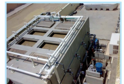
Bioréacteur à membrane dans un complexe commercial
