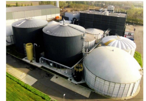
Digestion des boues - Transformation des déchets en énergie
