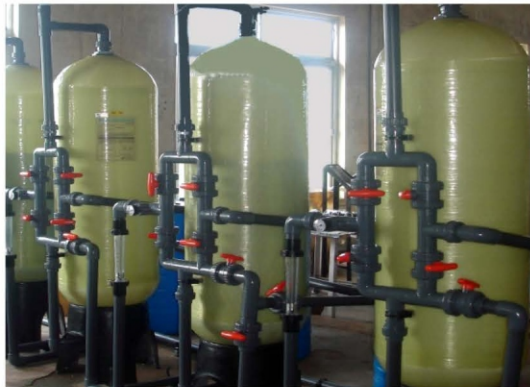
Usine d'élimination de l'arsenic pour le traitement des eaux souterraines
