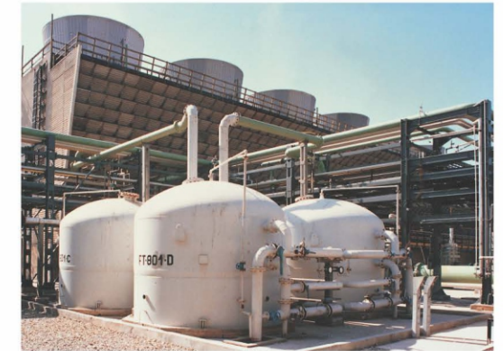
Traitement de l'eau de refroidissement
