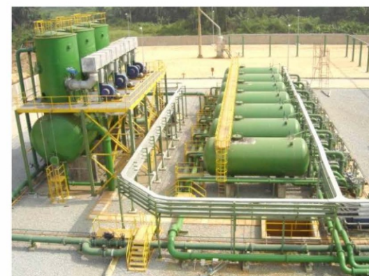
Система фильтрации на электростанции
