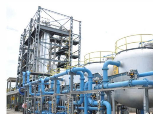
Система нулевого слива жидкости на заводе по производству синтетического каучука
