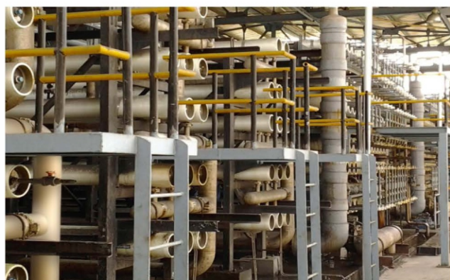
Обратный осмос (опреснение) морской воды на ТЭЦ
