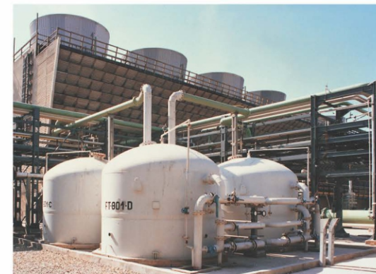
Очистка охлаждающей воды
