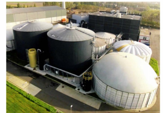
Сбраживание осадка – преобразование отходов в энергию
