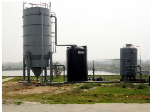
Непрерывный фильтр песка для очистки поверхностных вод
