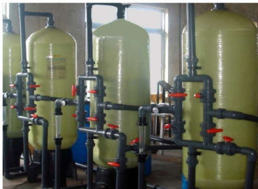
Установка удаления мышьяка для очистки грунтовых вод
