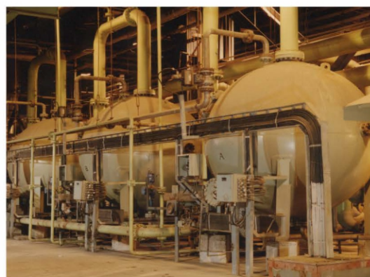
电厂凝结水精处理装置
