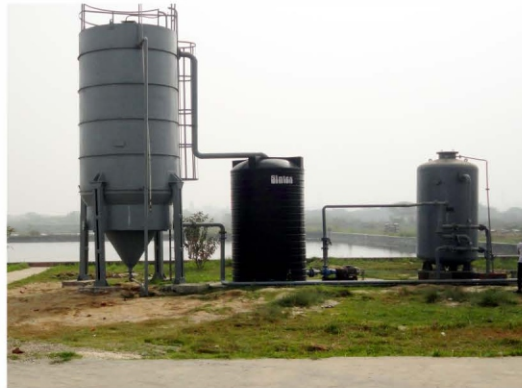
地表水处理用连续砂滤池
