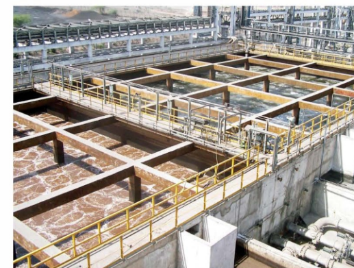
炼油厂污水处理厂
