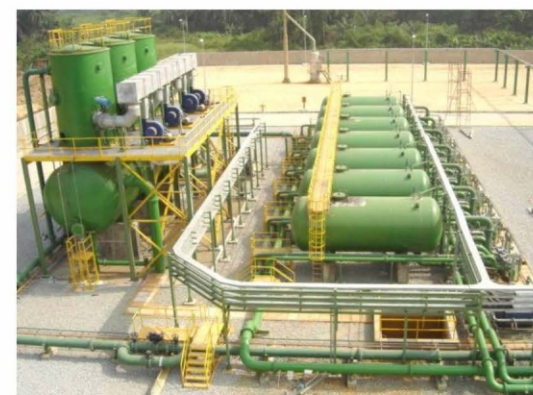
电厂过滤系统
