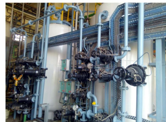
化工厂乙二醇净化设备
