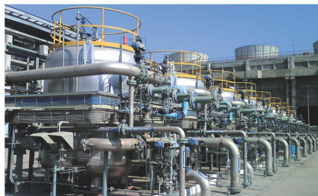
石油行业的脱盐装置
