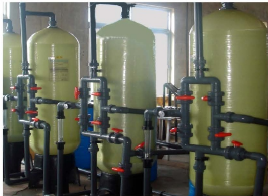
地下水除砷设备
