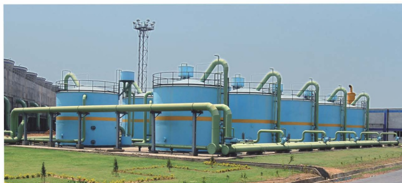
钢铁厂的侧流过滤器
