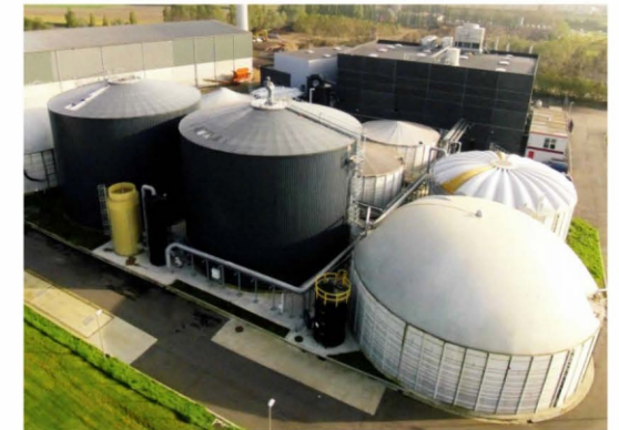
污泥处理-垃圾转化为能源
