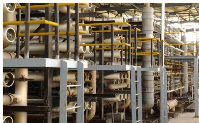
火力发电厂海水反渗透 (淡化) 设备
