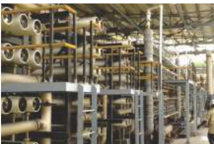
Impianto ad osmosi inversa
