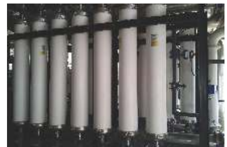
Impianto di ultrafiltrazione
