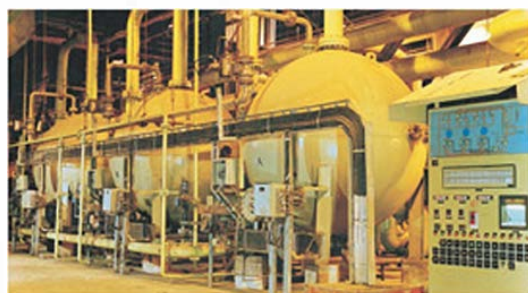
冷凝液纯化槽
