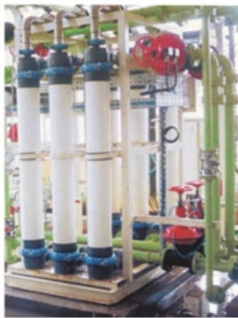
超ろ過プラント
