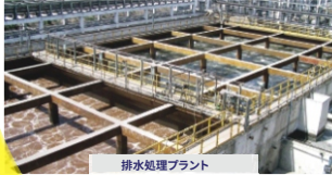
排水処理プラント
