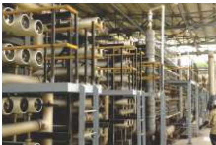
Установка обратного осмоса
