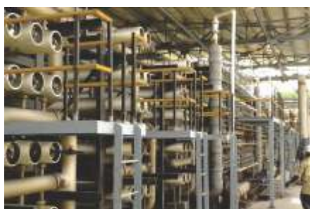
逆浸透膜プラント
