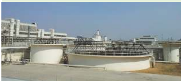
3600 m 3 /d effluent treatment
